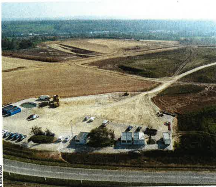
Les travaux d'aménagement de la zone d'activités de 177 ha, sur les communes de Brognard, Alenjoie et Dambenois, s'étalent sur trois phases jusqu'en 2015.
